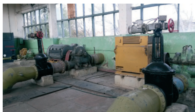
Рис. 1. Машинный зал подкачивающей насосной станции
