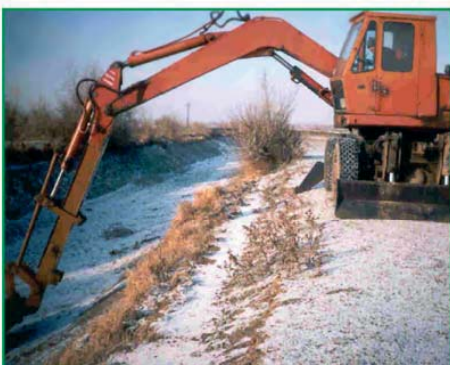
Очистка канала от наносов экскаватором ЭО-3323М(СГАУ) с последующим разравниванием наносного грунта бульдозером
