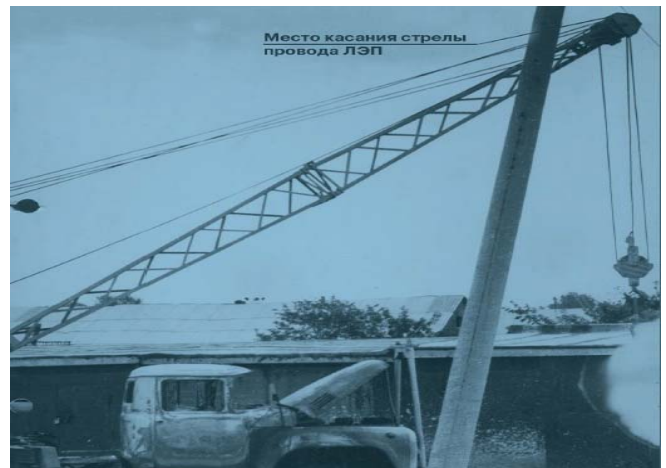
Рис. 9. Место касания стрелы грузоподъемной машины провода ЛЭП
