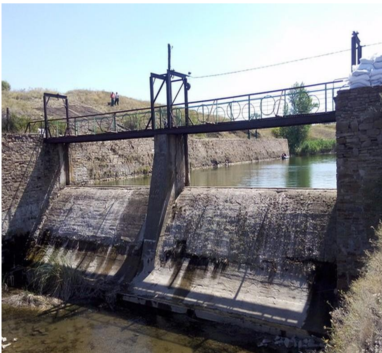
Рисунок 6 – Разрушение дамбы хранилища Дзержинского фенольного завода (Донбасс-инфо).
