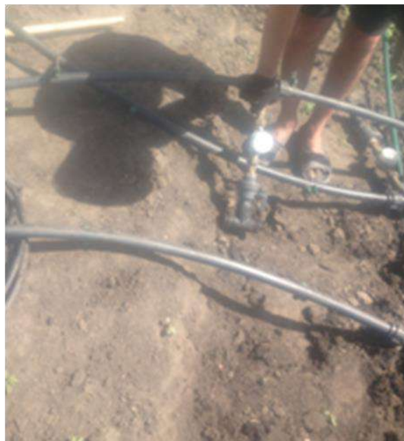
Магистральный и распределительные трубопроводы
